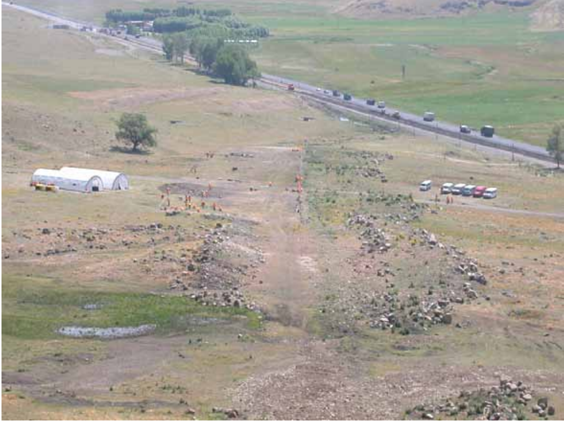
Resim 7: Tetikom batıdan kazı öncesi bir görünüm. Önceki İran Doğal Gaz Hattı tahribatı.
